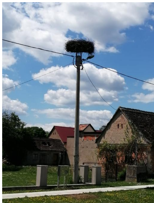
Slika 4. Gnijezdo na stupu u električnoj mreži s rasvjetom (Foto: Nikolina Nađ)
